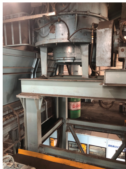
Fot. 11. Masa podawana jest bezpośrednio z mieszarki TM do zbiornika masy nad formierką DISAMATIC Fig. 11. TM mixer is feeding directly into the sand supply unit of the DISAMATIC
